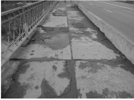
Рис. 1. Відсутність покриття та гідроізоляції на тротуарах
