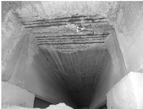
Рис. 3. Пошкодження захисного шару бетону, корозія арматури плити
